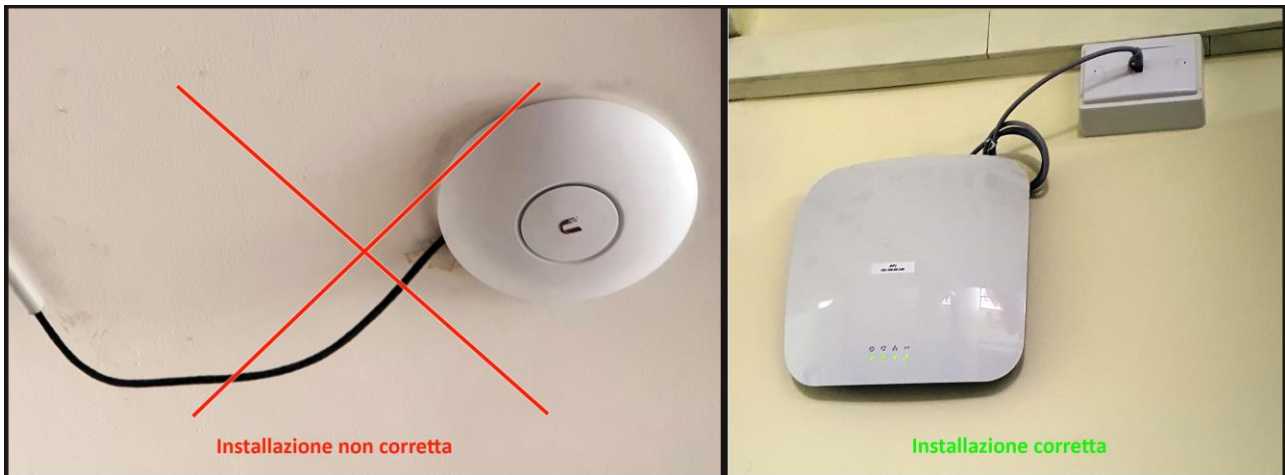
Figura 10 – Installazione corretta dell'Access Point
